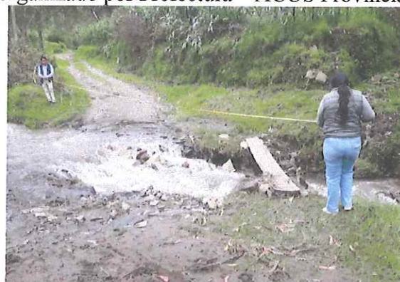
Acompañamiento al técnico de la Prefectura para realizar el Estudio previo construcción cabezales y colocación de tubos, en vía Shacundo – Capito.
