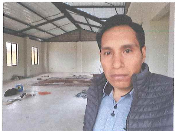
Seguimiento y constatación del avance de la obra de la casa parroquial segunda etapa.
