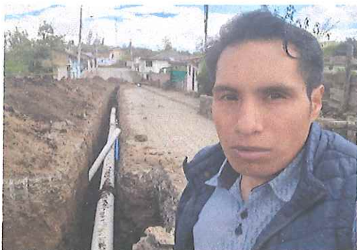
Verificación de colocación de tubos de alcantarillado en el Barrio Tres de Mayo
