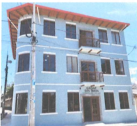
Seguimiento y constatación del avance de la obra de la casa parroquial segunda etapa.
