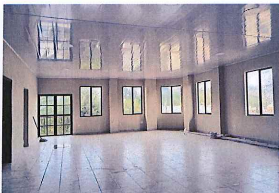
Verificación y constatación de avances de colocación de tumbado de segunda etapa de la casa parroquial
