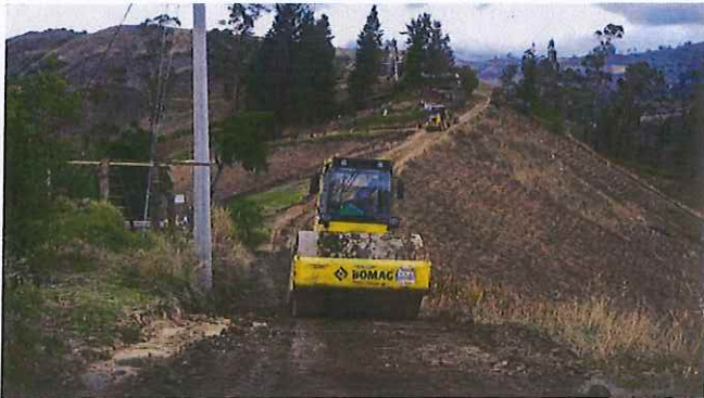
Coordinación de trabajos de vialidad con maquinaria de municipio cantón Guaranda en mantenimiento y rasanteo en Coventillo.
